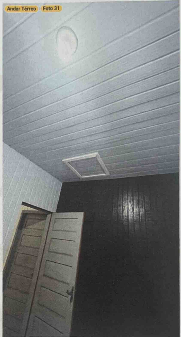
Escotilha de manutenções - forro do quarto
