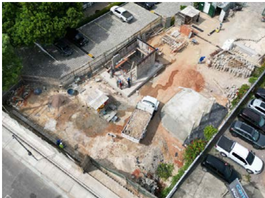
Figura - Obra da guarita do prédio sede do Ministério Público do Estado do Amazonas – MPAM
